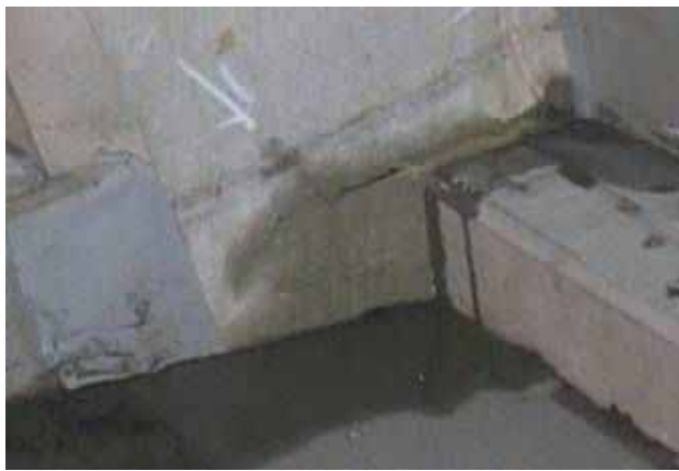
漏水部分(吐出水アリ・削工・止水セメント) 注意:漏水想定部分への事前塗布が重要
